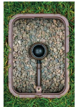
Automatisches Spülventil installiert
